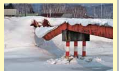
雪の重みで変形した橋脚(2018.2.)
